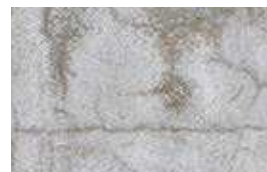
FEUCHTER UNTERGRUND - bis zu 5 % Restfeuchte
